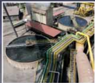
TRATAMENTO DE ÁGUA E EFLUENTES LÍQUIDOS
